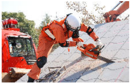
倒壊家屋内生き埋め者の救出
